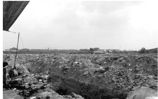
図12 曲阜市 取り壊された商店街
